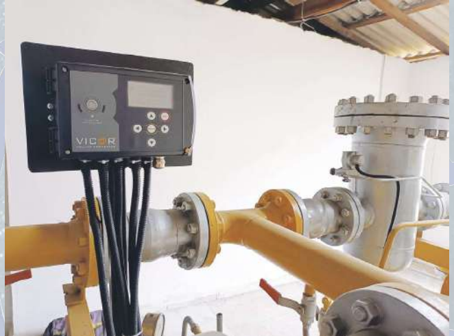
Doğalgaz 19 adet Ana İstasyonlarının SCADA sistem revizyonu işlemleri 2023 yılında tamamlanmıştır.
